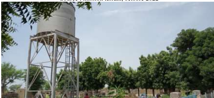
Photo 12 : Systèmes de captages et stockage Dan Dila/Bandé.
