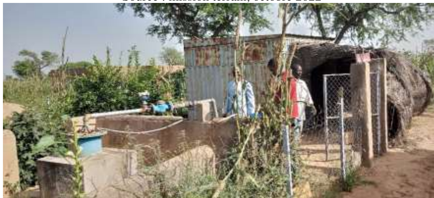
Photo 16 : Aperçu du système de captage de Birgi Babba/Kourni
