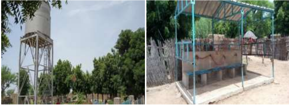
Photo 23 : Systèmes de captages et stockage et rampe d'eau de Dan Dila/Bandé.
