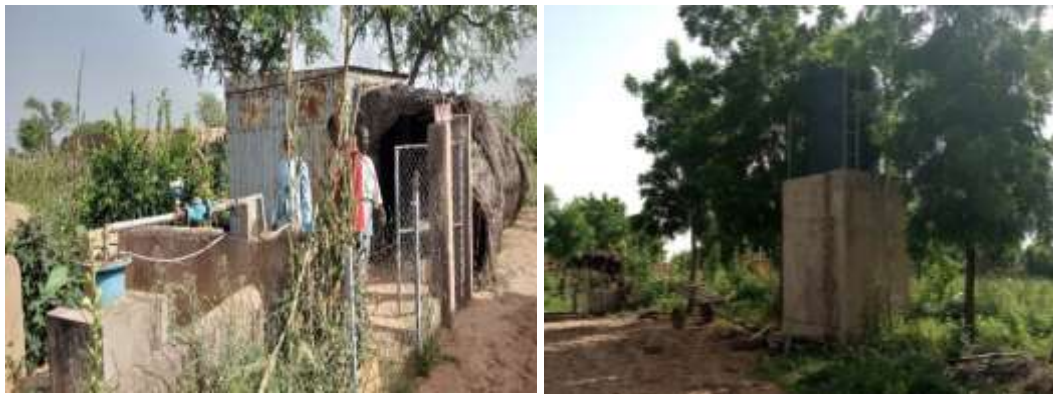
Photo 24 : Aperçu du système de captage et réservoir et de la rampe d'eau de Birgi Babba/Kourni
