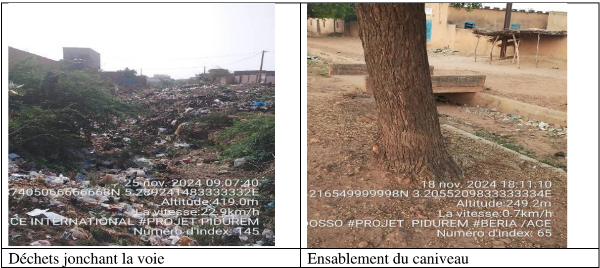
Photo 10 : Image illustrant l'état de certains ouvrages et tronçons (visites de terrain)
