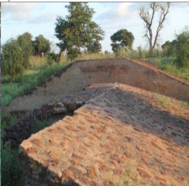
Partie déversant en perré maçonnée dégradée
