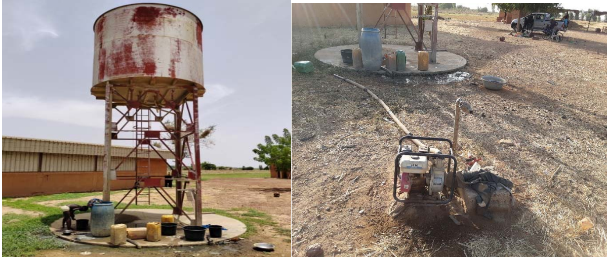
Planche 6 : Vue du réservoir métallique (Photo 13) et du forage (Photo 14)
